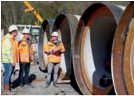
Die dickwandigen Stahlbetonrohre werden einzeln auf die Baustelle geliefert. Vor dem Einbau werden die Rohre noch einmal geprüft. Fotos: Güteschutz Kanalbau
